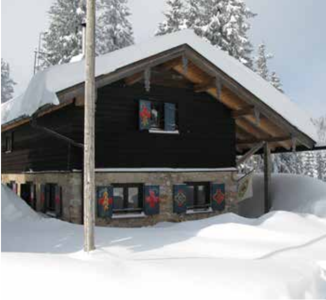
■ Unsere Grozach-Diensthütte – ein Sanierungsfall.
